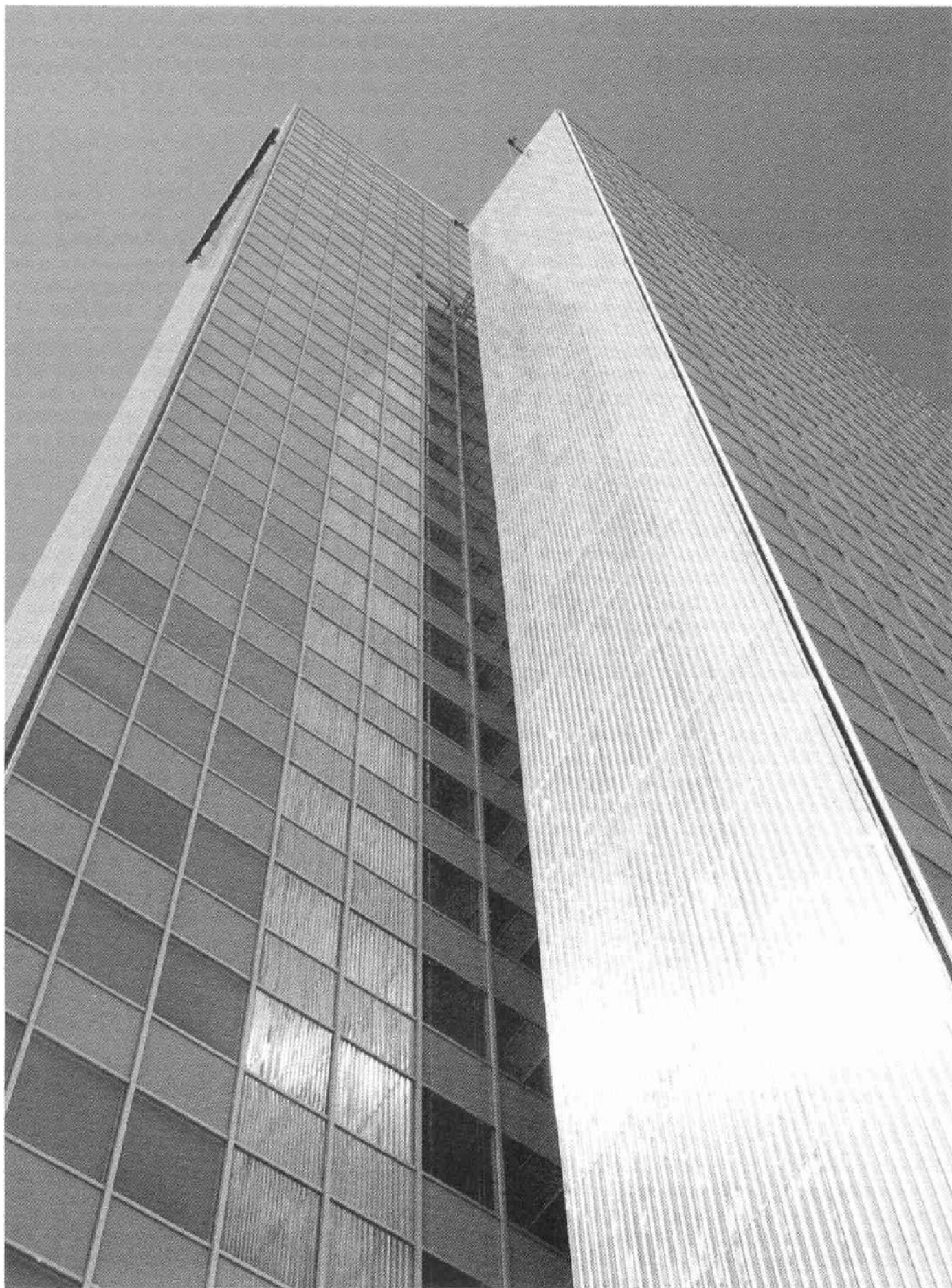
Fassadenelemente aus profiliertem Edelstahl-Rostfrei-Blech nach 35 Jahren in Großstadt-Atmosphäre („Dreischeiben-Haus“, Düsseldorf)
